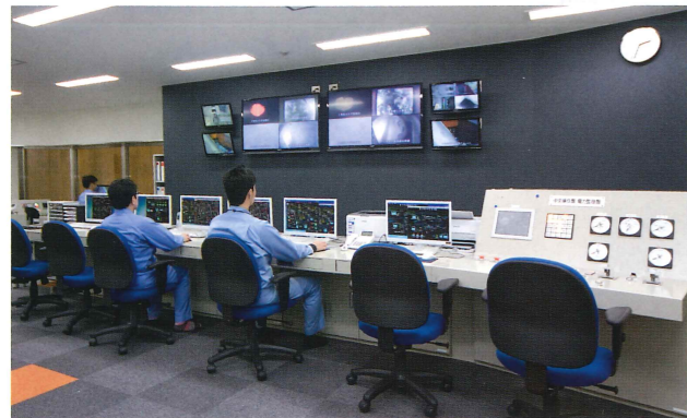
●中央制御室 熱回収施設内の機器と設備全体の監視・制御や運転操作をここで集中して行っています。
